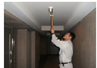
警報設備の定期点検
