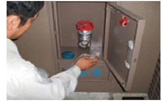
連結送水管定期点検
