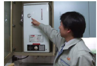
電気温水器定期点検
