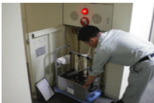
消防設備や排煙設備もお任せ
